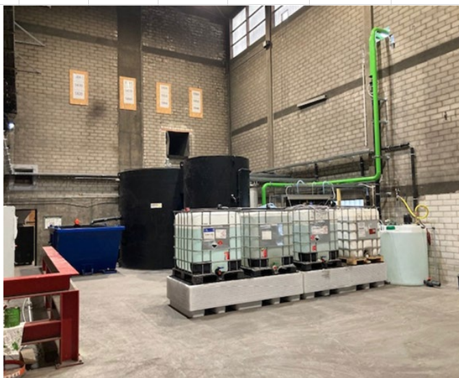
Wasseraufbereitungsanlage Strangguss – Inbetriebnahme H2-2021
